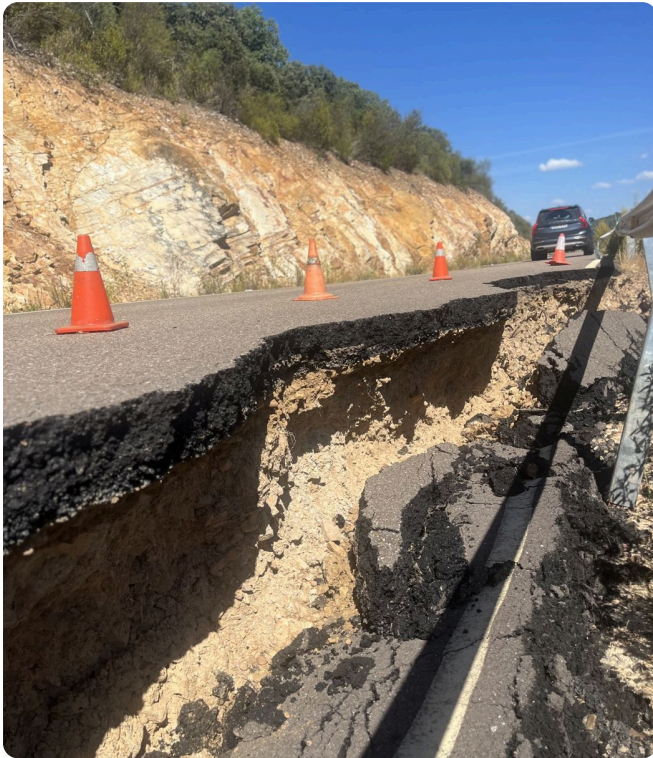
Junio 2026. El socavón bajo la calzada, con vehículos circulando a pocos metros.
